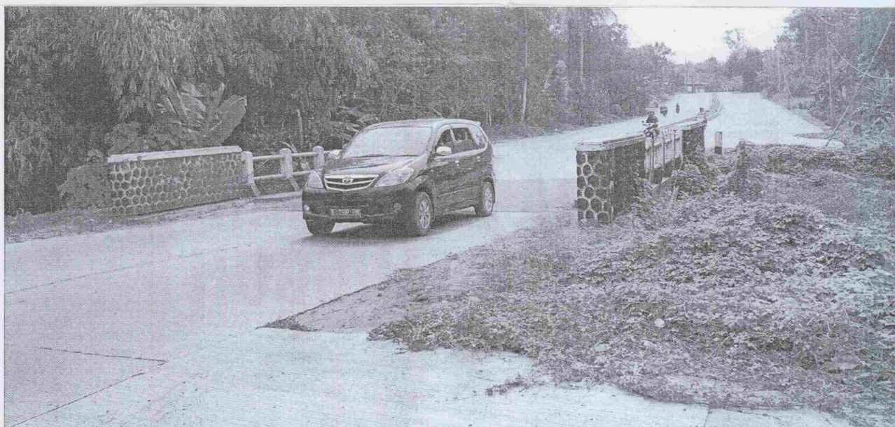
BERBAHAYA: Sejumlah pengendara melintasi Jalan Palima-Cinangka, Kecamatan Cinangka yang pembangunannya belum tuntas, Minggu (29/9)
